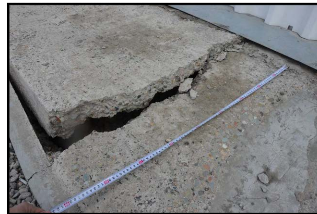
Фото 7.12. Разрушение арматуры в железобетонной плите
